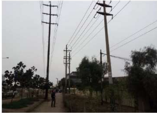
Vista postes de alta y media tensión.
